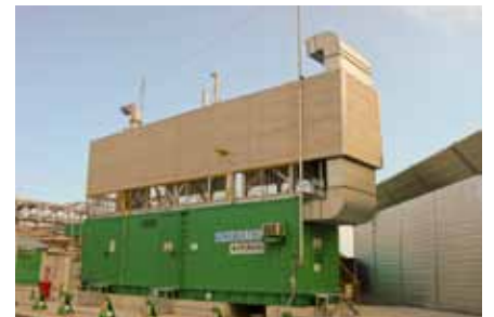
ユニマテックの自家発電装置
