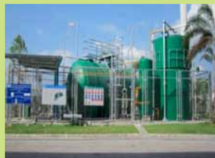
バイオガス発生装置
